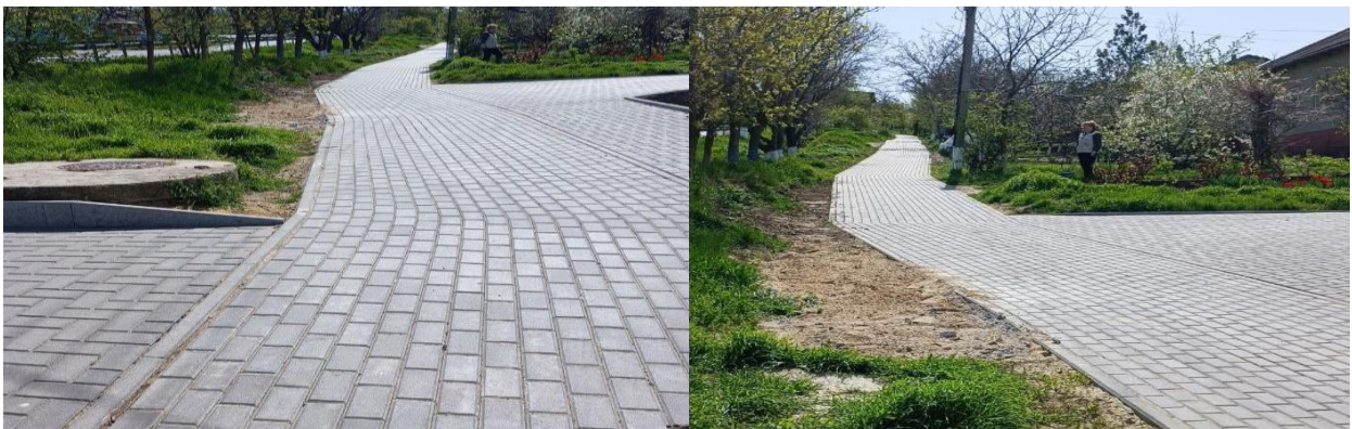
(Фотографии сделаны контролерами СПГ в ходе проведенного визуального осмотра)
