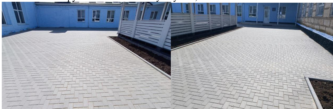
(Фотографии сделаны контролерами СПГ в ходе проведенного визуального осмотра)
