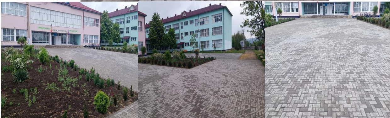
(фотографии сделаны контролерами СПГ в ходе проведенного визуального осмотра)
