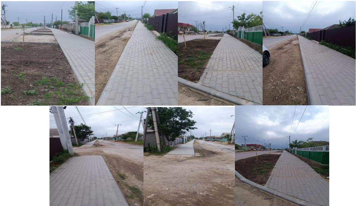
(Тротуар по ул.Ананьева г.Вулканешты. Фотографии сделаны контролерами СПГ в ходе проведенного визуального осмотра)
