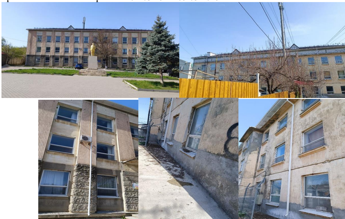
(фотографии сделаны контролерами СПГ в ходе проведенного визуального осмотра).
