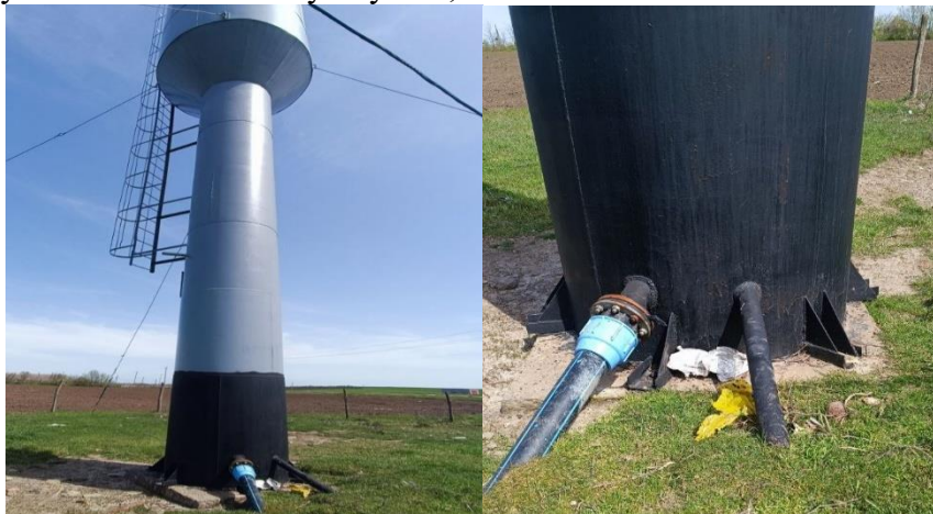
(Фотографии сделаны контролерами СПГ в ходе проведенного визуального осмотра)
