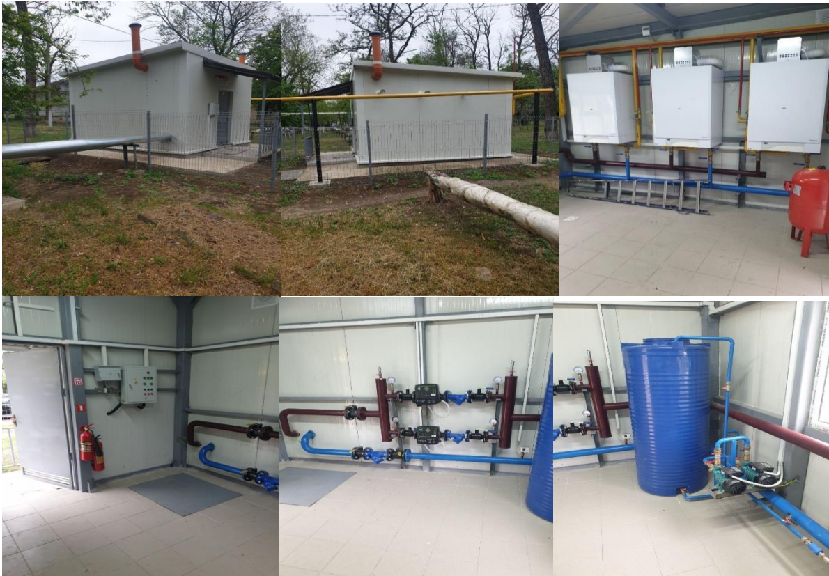
(фотографии сделаны контролерами СПГ в ходе проведенного визуального осмотра).
