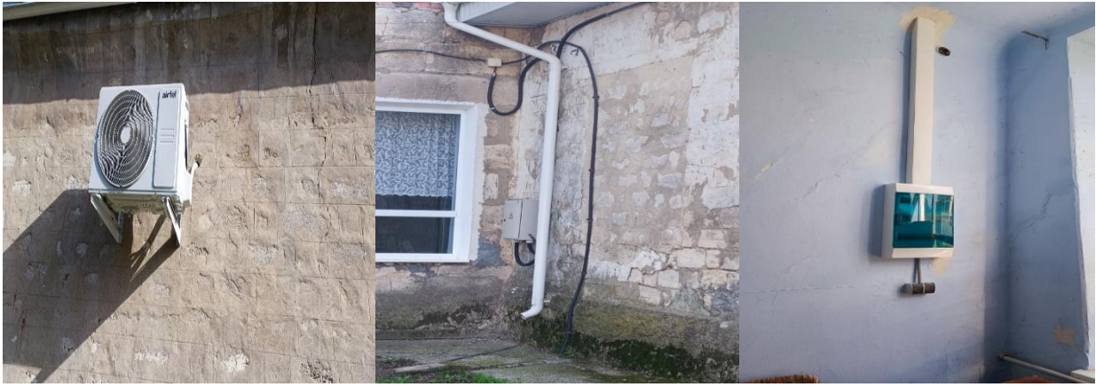
(фотографии сделаны контролерами СПГ в ходе проведенного визуального осмотра)
